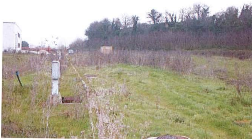
Foto n. 24 - tratto della Via S. Pertini non ultimato
