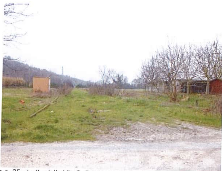
Foto n. 25 - tratto della Via S. Pertini non ultimato
