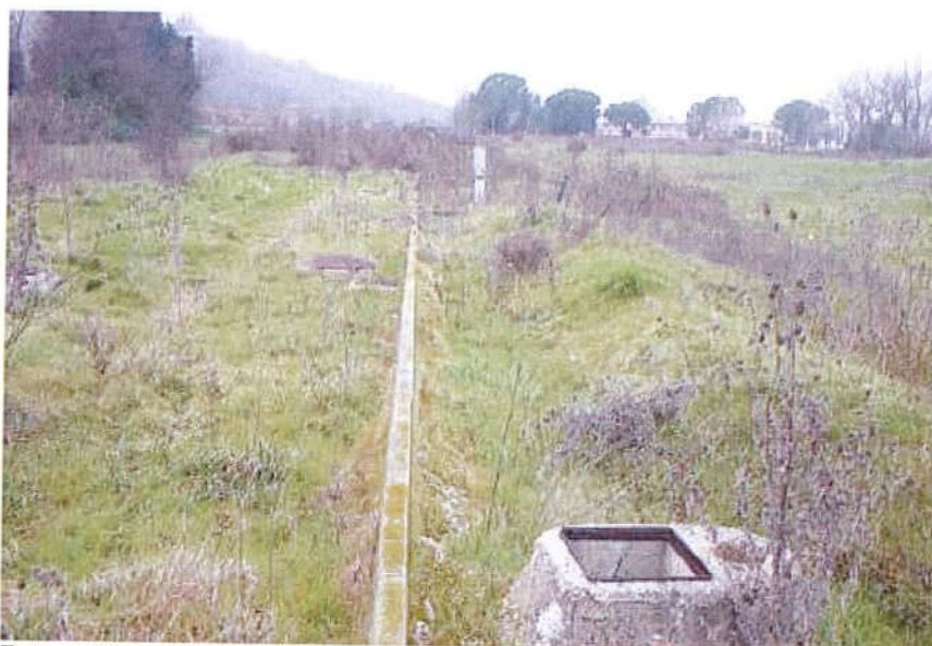
Foto n. 22- tratto della Via S. Pertini non ultimato
