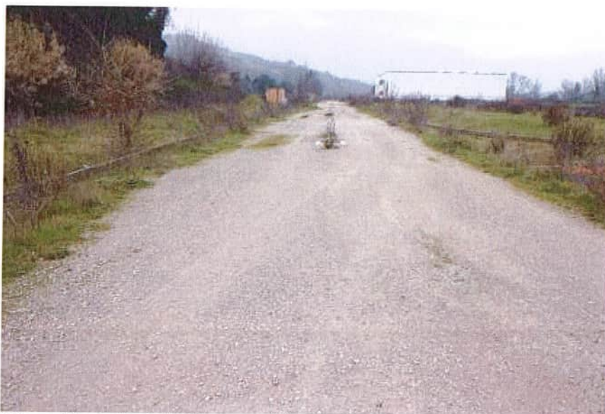
Foto n. 15 - tratto della Via S. Pertini non ultimato
