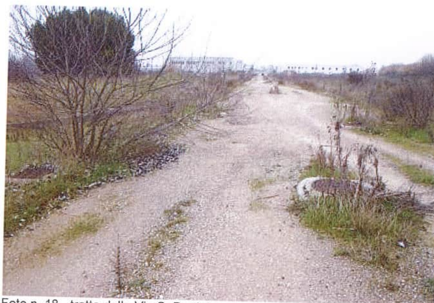
Foto n. 18 - tratto della Via S. Pertini non ultimato
