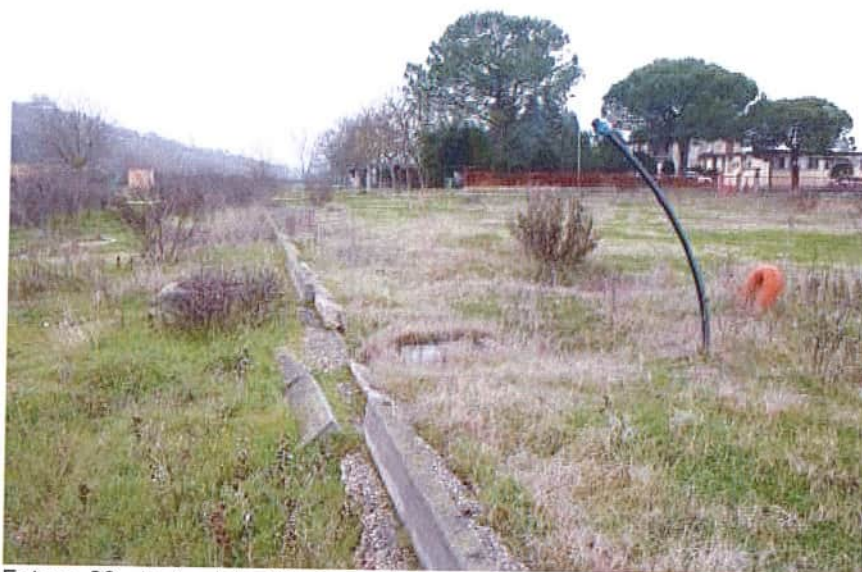
Foto n. 23 - tratto della Via S. Pertini non ultimato
