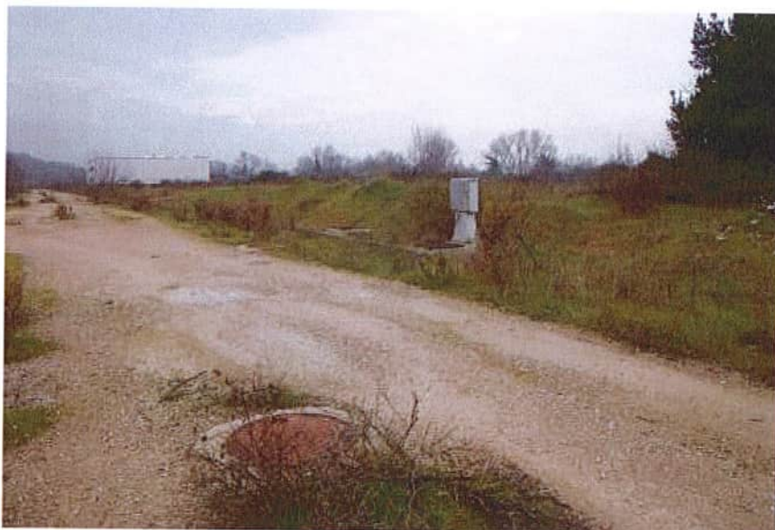
Foto n. 16 - tratto della Via S. Pertini non ultimato
